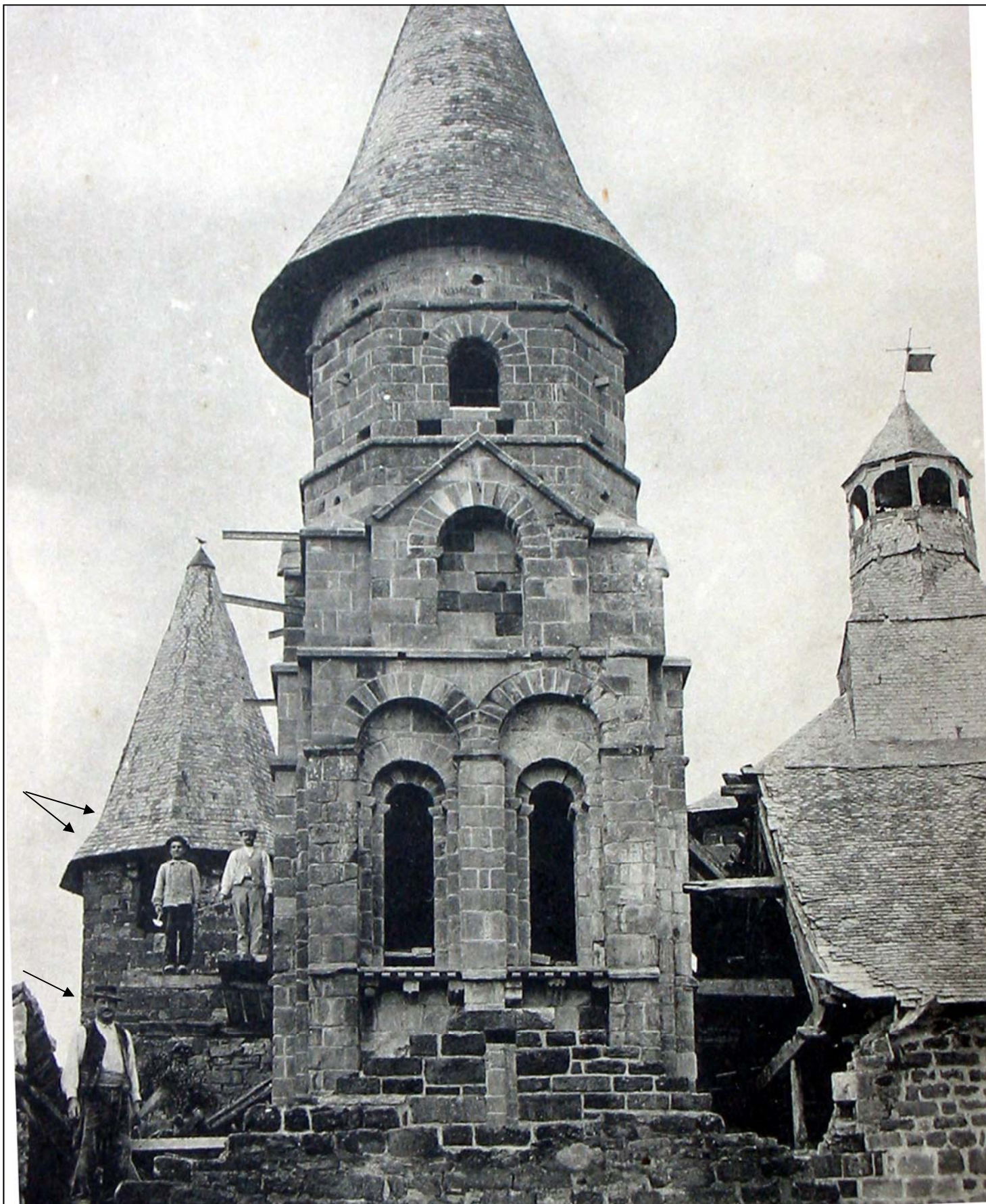
Carte postale du début du 20ème siècle avec vue des travaux de restauration du côté du chevet de l'église (à l'est). A gauche, trois ouvriers, sans vertige apparent ni barrière de protection (!), dégagent les toitures qui masquaient l'architecture du clocher roman du 11ème siècle (le plus ancien édifice de Collonges). Et à droite (à l'angle nord-ouest) la tour fortifiée érigée pendant la Guerre de Cent Ans encore cachée par la toiture surélevée protégeant la nef nord.
